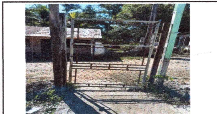
Foto 5: Porton en mal estado
