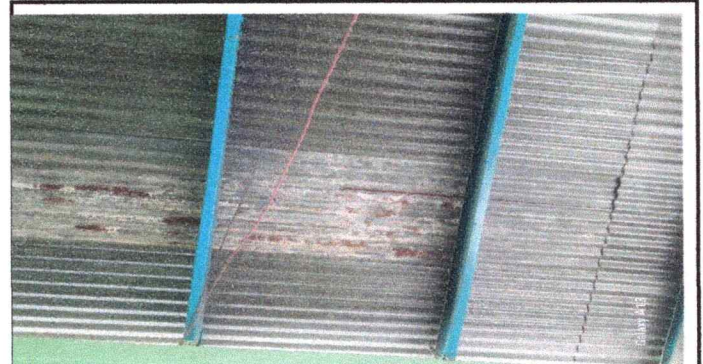
Foto 4: Laminas dañadas y perforadas en el modulo 3.
